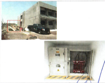
F3: ubicación de la subestación eléctrica
